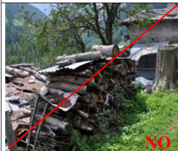
Fig.3- Coperture arrugginite e mal posizionate
